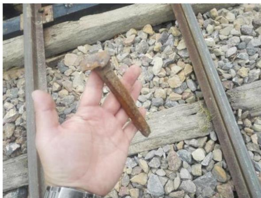
Figura 16 Defecto de no fijación en el durmiente
