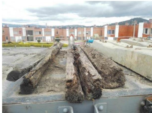
Figura 14 Pudrición del durmiente de madera
