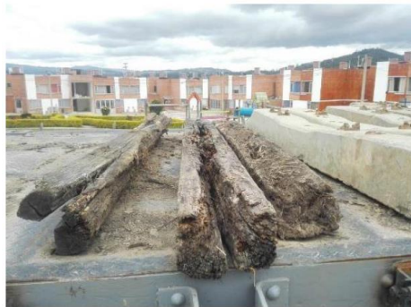
Figura 14 Pudrición del durmiente de madera
