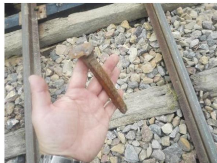
Figura 16 Defecto de no fijación en el durmiente
