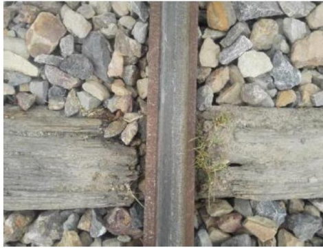
Figura 17 Rompimiento de madera
